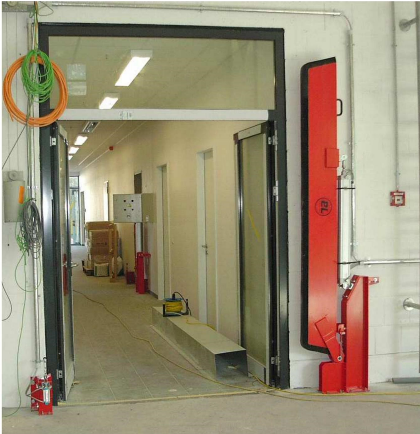
◀ Barrière à déclenchement PNEUMATIQUE sur ALARME.
